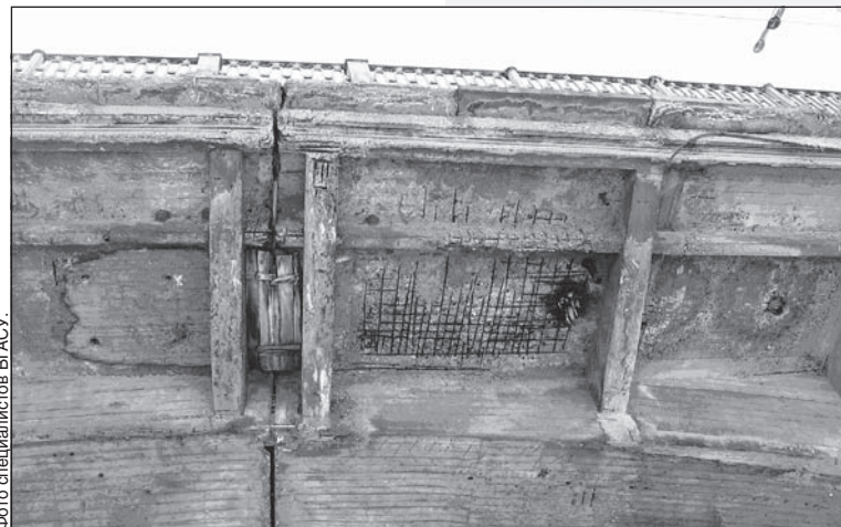
Местами арматура конструкций на ВоГРЭСовском мосту уже оголилась и проржавела
