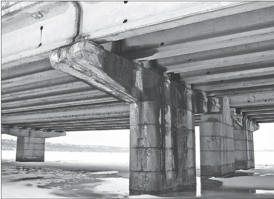
В швах между пролётами моста обязательно должна быть резиновая прокладка, но на Северном мосту её нет, и сточные воды разрушают опоры
